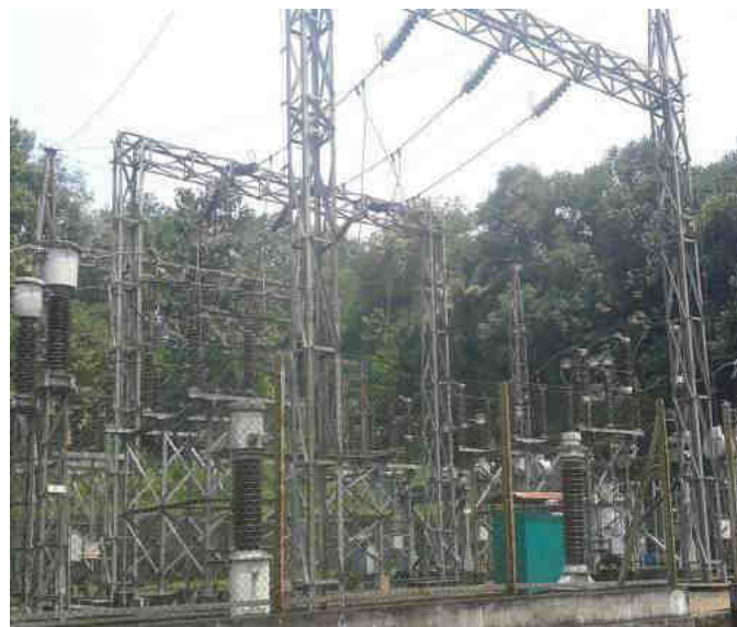
110 KV Substation Erattupetta
